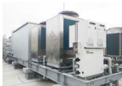
業務用エコキュート(中)と貯湯槽(奥)
